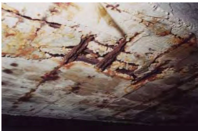
Fotografija br.4 – Stupanj oštećenja "B" poprečnog nosača
