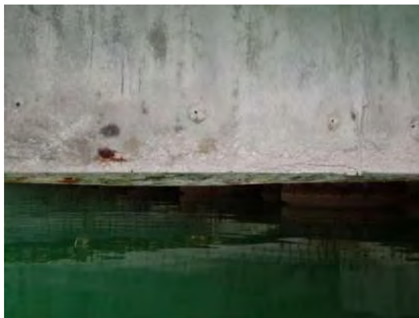
Fotografija br.5 – Stupanj oštećenja "B" poprečnog nosača
