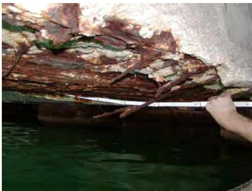
Fotografija br.6 – Stupanj oštećenja "C" poprečnog nosača
