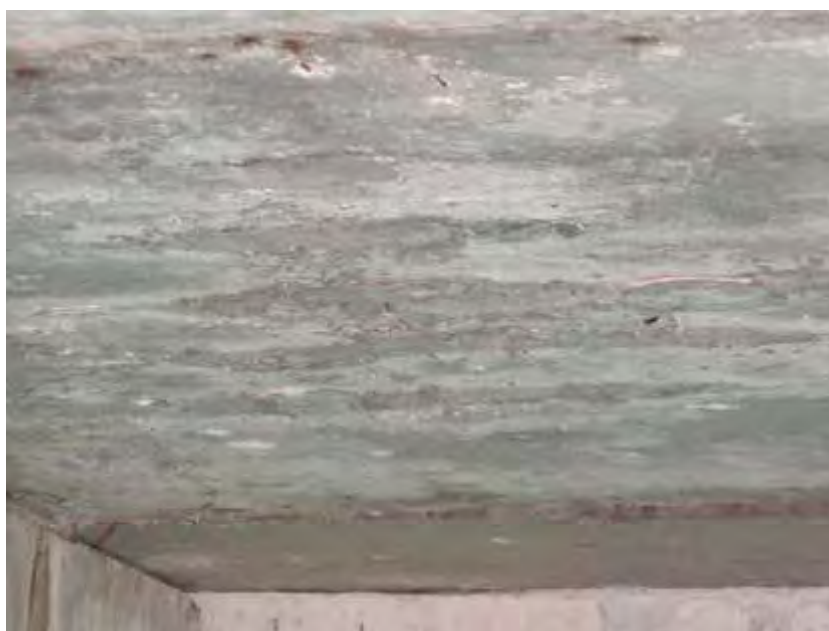
Fotografija br.9 –Prethodno izvedena sanacija pločastih nosača
