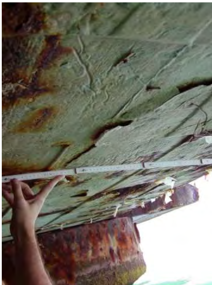
Fotografija br.3 – Stupanj oštećenja "A" uzdužnog nosača
