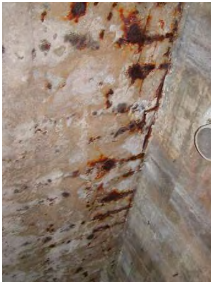
Fotografija br.8 –Oštećenje pločastog nosača na spoju s masivnim zidom
